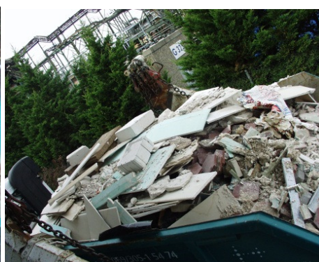
überladene und falsch befüllte Mulde
